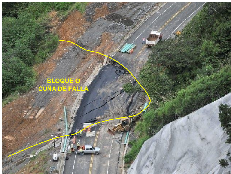
FIGURA 19.- FALLA ROTACIONAL EN UN CAMINO PRÓXIMO A UNA CAÑADA
