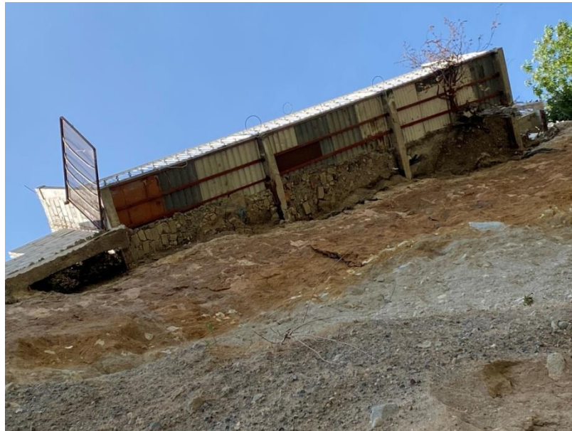
FIGURA 17.- POR EFECTOS DEL INTEMPERISMO EL SUELO DE APOYO A LA CIMENTACIÓN DEL PATIO DE UNA CASA, SE DESPRENDE DEJANDOLA AL DESCUBIERTO Y EN PELIGRO DE CAER. LA UBUCACIÓN DEL SITIO ES LA MISMA DE LA FIGURA ANTERIOR.
