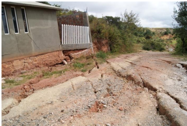
FIGURA 11.- CAMINO DE TERRACERÍA DE SANTIAGO MITLALTONGO AFECTADO POR EL CREEP DEL CERRO LA PEÑA COLORADA, UBICADO AL NORTE DE LA POBLACIÓN.
