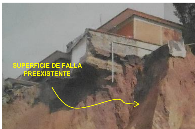
FIGURA 6.- FALLA EN LA COLONIA SANTA FE, CUAJIMALPA, MÉXICO. AUNQUE YA EXISTÍA UNA SUPERFICIE POTENCIAL DE FALLA, EL DESLIZAMIENTO SE PRESENTÓ POR HABER REMOVIDO EL PIE DEL TALUD PARA DAR PASO A UNA VIALIDAD.
